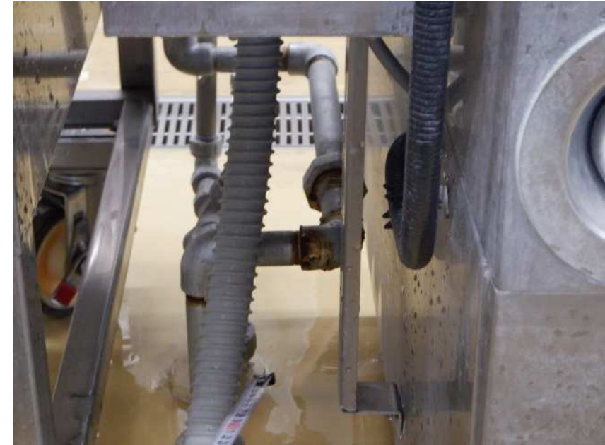
↑床面から洗浄機本体までの配管が錆びているため更新する
