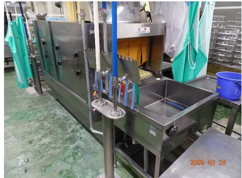
水栓柱あり→機械の延長を伸ばせない
