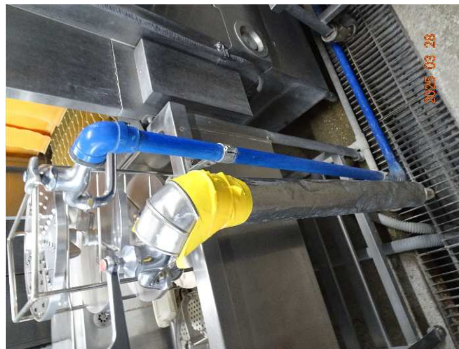
給水・給湯管・水栓の状態悪い→更新
